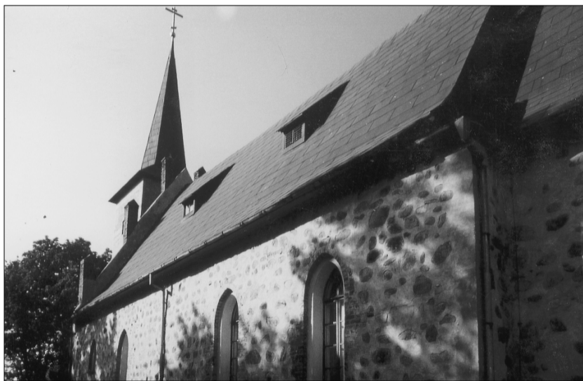
Ansicht der Südfront: Das Kirchenschiff, der älteste Teil des Gotteshauses, ist aus Feldsteinmauerwerk errichtet. Nur Fenstergewände und Mauerecken wurden in Backsteinmauerwerk hergestellt. Der Baustil ist typisch für die Sakralbauten des Samlandes aus dieser Zeit. Fotos (2): Papendick
