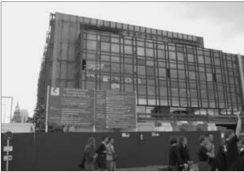
Wichtiger Zeitzeuge zum Abriss freigegeben: Der Palast der Republik erinnert an die DDR und ist somit von historischer Bedeutung. Zugleich ist er aber für viele so häßlich, daß sie das sozialistische Bauwerk zugunsten eines Wiederaufbaus des Schlosses weichen sehen wollen. Foto: HTU
