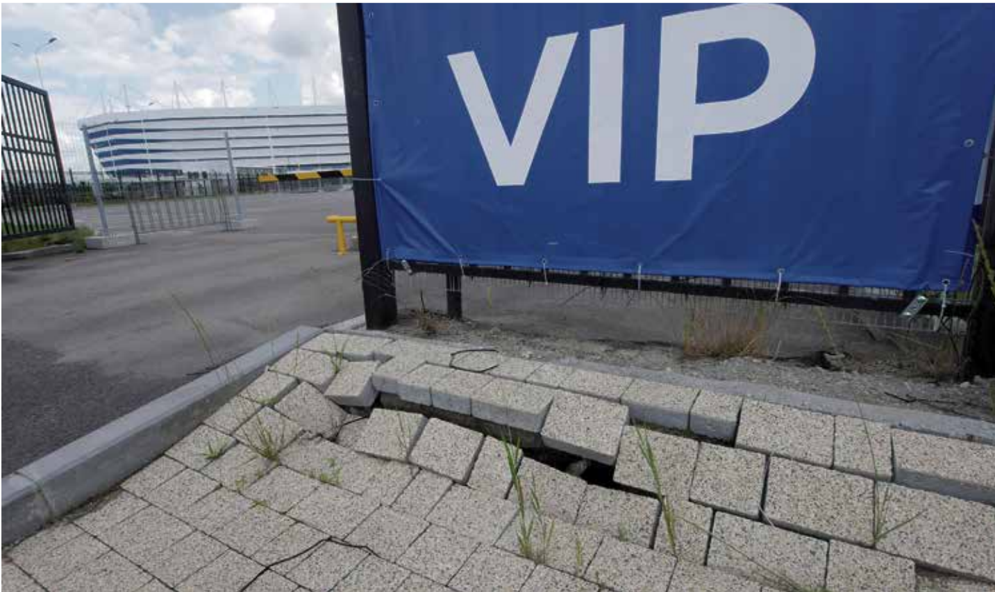
Lose Pflastersteine in der Nähe des Stadions: Bauarbeiten haben zu Absenkungen geführt
