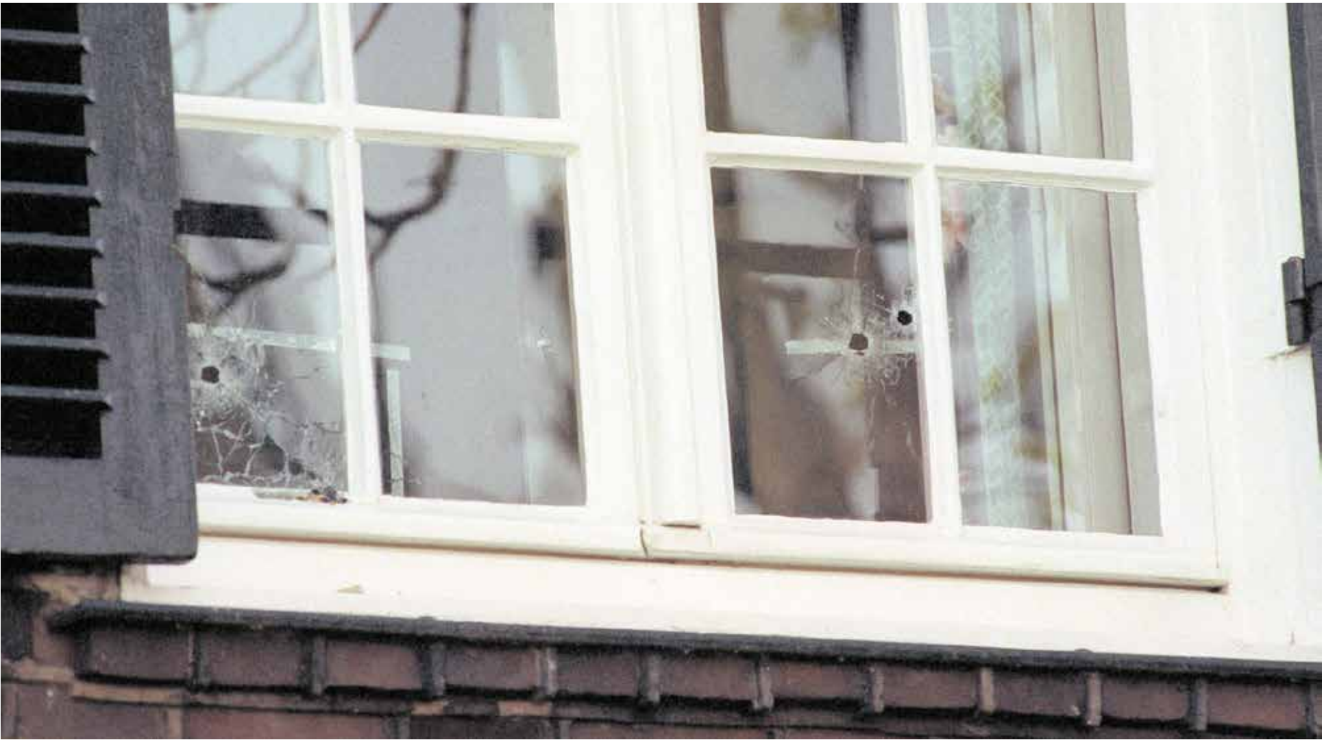
Fenster des Arbeitszimmers von Detlev Rohwedder: In den unteren Fenstersegmenten befinden sich die drei Einschusslöcher
