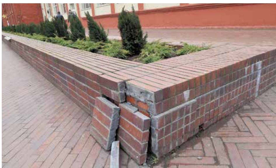
Schon wieder defekt: Fußgängerzone in der Rossokowskogo-Straße
