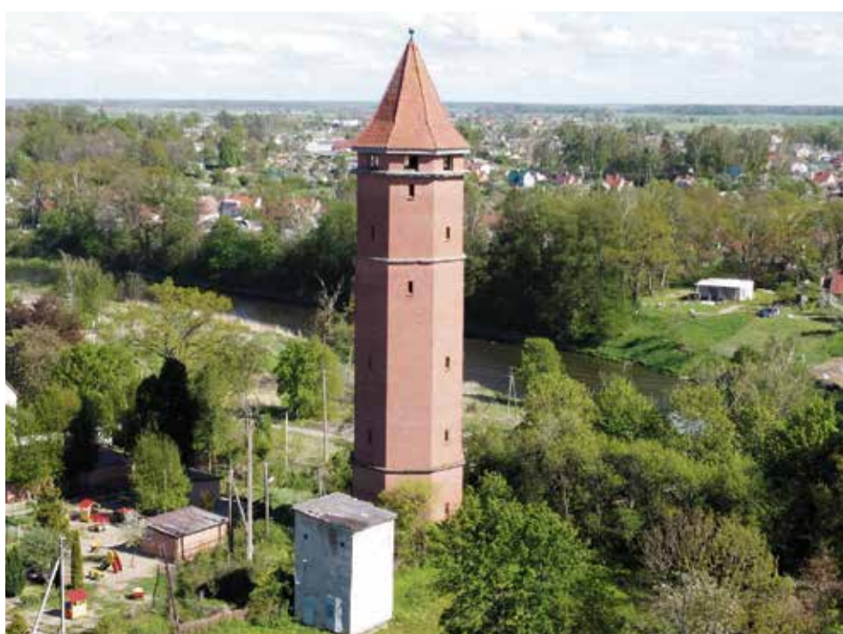
Benötigt Wartung und Pflege: Der Wasserturm in Friedland
