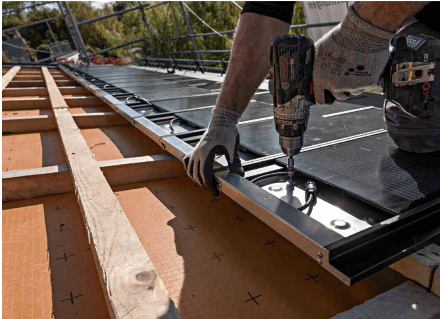
Solarmodule aus deutscher Herstellung: Solardachziegel eignen sich auch für denkmalgeschützte Häuser
