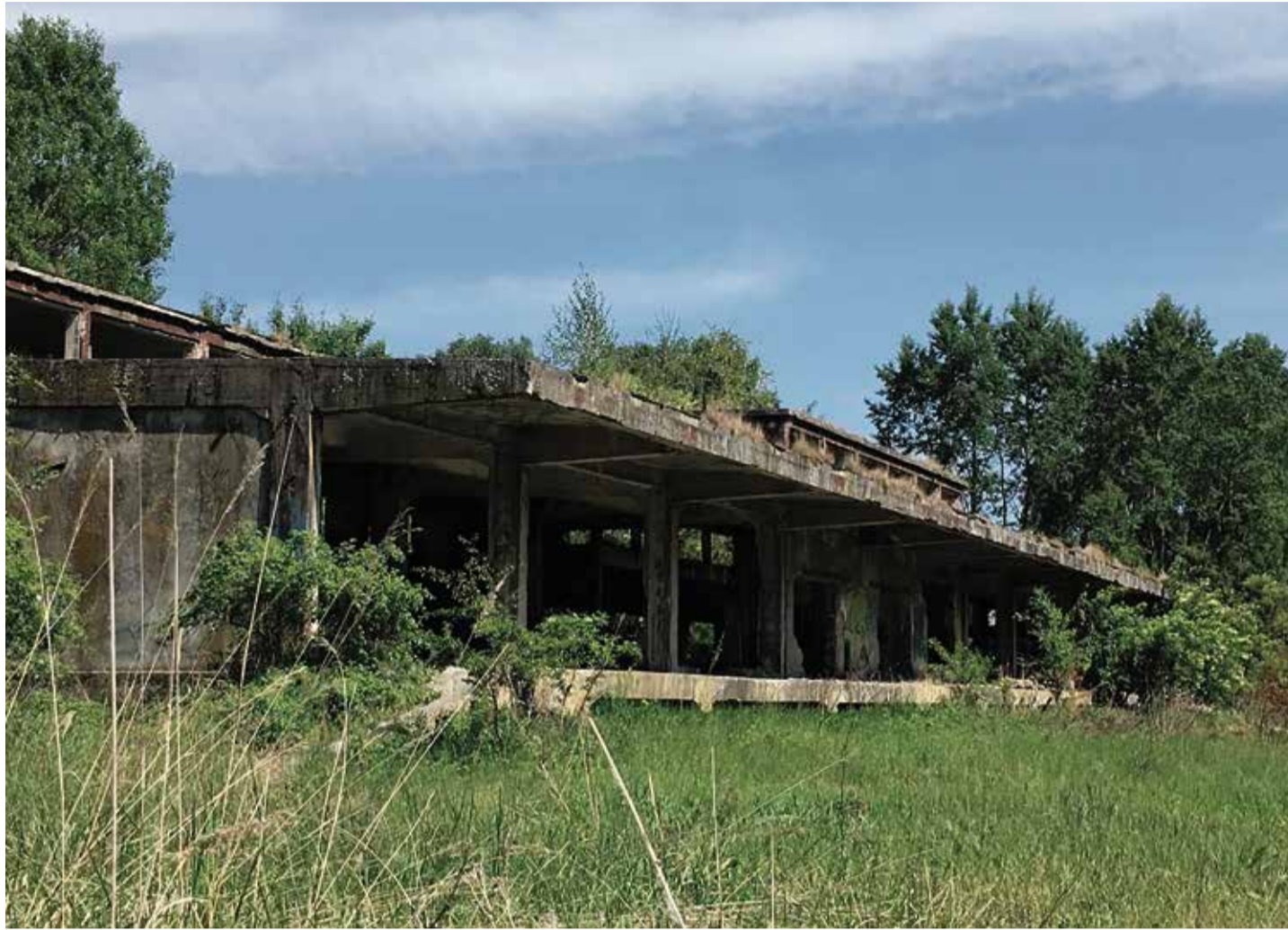
Die Natur holt sich alles zurück: Der einst betriebseigene Güterbahnhof auf dem Industriegelände des Hydrierwerks Pölitz
