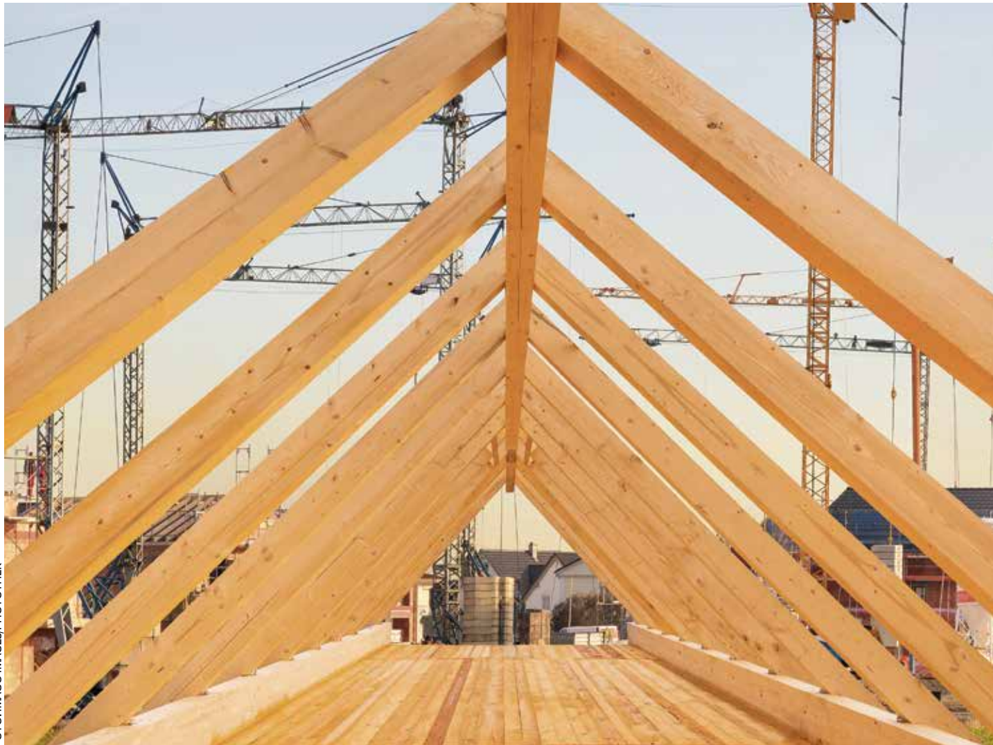
Wann wird das Dach aufgesetzt? Von einem Bauboom ist Deutschland derzeit weit entfernt
