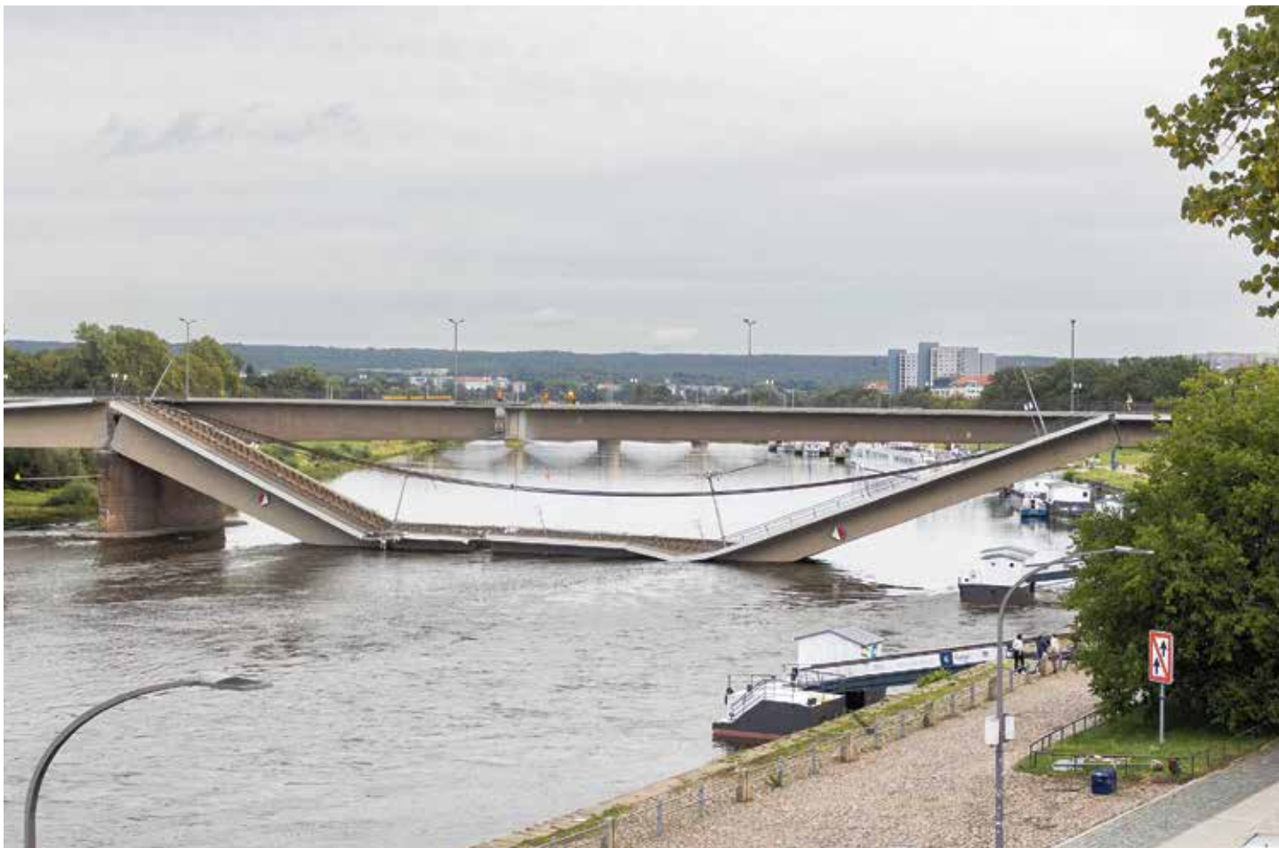
So etwas gab es in Deutschland seit über 100 Jahren nicht: ein Brückeneinsturz im öffentlichen Verkehrsnetz. Die komplette deutsche Infrastruktur ist marode, aber wegen Geldmangel wird kaum saniert Foto: imago/Andreas Weihs
