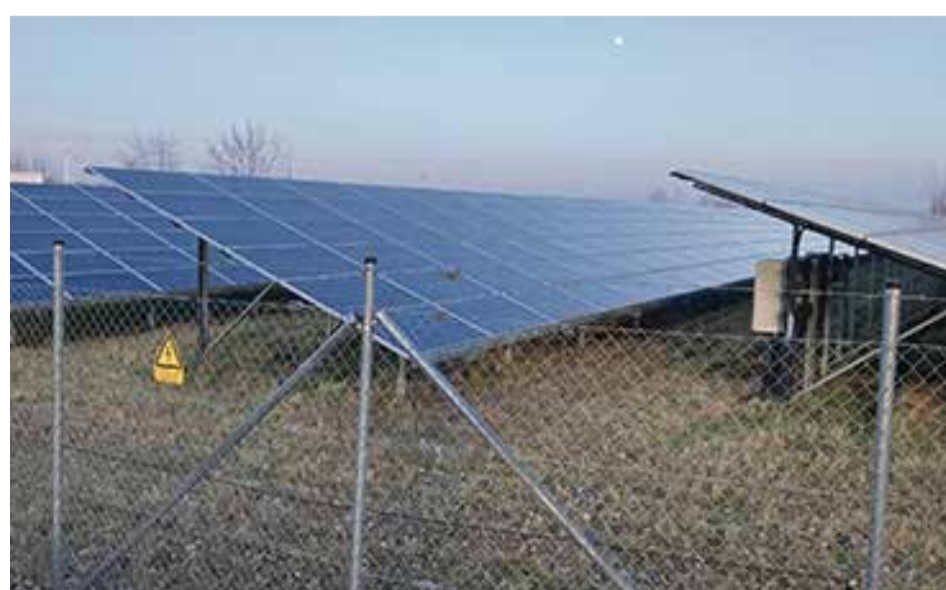
Bestehende Solarmodule unweit vom neuen Photovoltaikfeld nahe Hornbach
