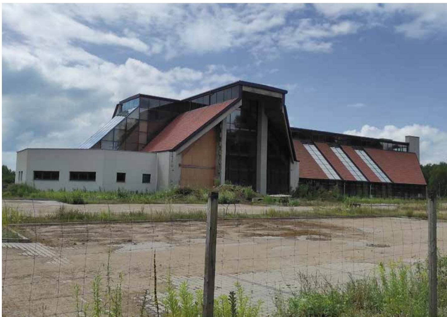
Vom Verfall gezeichnet: Der begonnene Rohbau des Naturheilzentrums in Goldap kann nicht fertiggestellt werden Foto: D.K.
